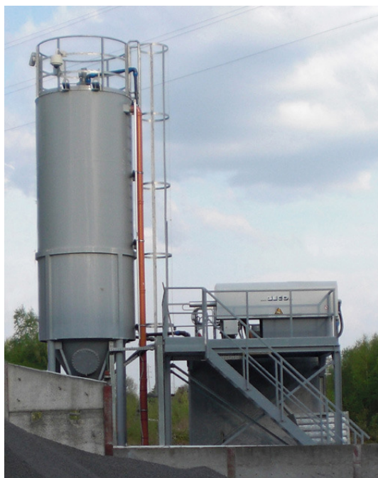
Silo de traitement d'eau AQUACLEAN et filtre-presse à chambres ECOPRESS.
