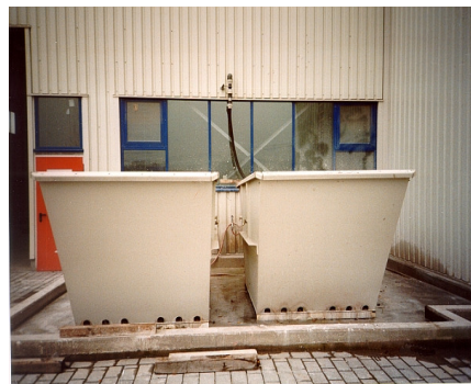
Solution combinée efficace dans une usine de briques à béton. Le remplissage tour à tour aide à comprimer la boue encore plus.
