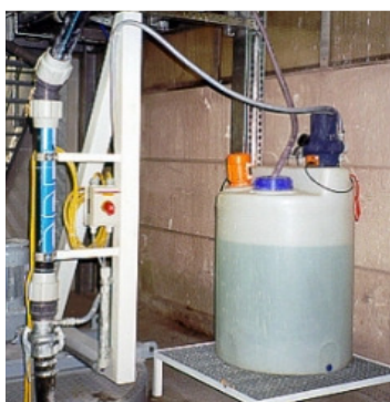
Station de dosage du floculant. Le floculant sert à accélérer la sédimentation des particules en suspension (p. ex. des pigments colorants). Ce qui accroît le débit.
