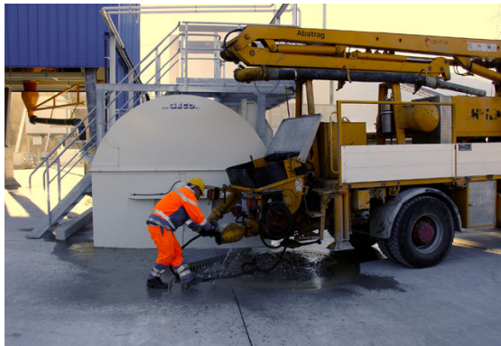
FLOTMAT-15-Kombi : admission de plain-pied pour le lavage des pompes à béton.
